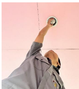
ภาพที่ 2 การเปลี่ยนหลอดไฟแบบทั่วไป
